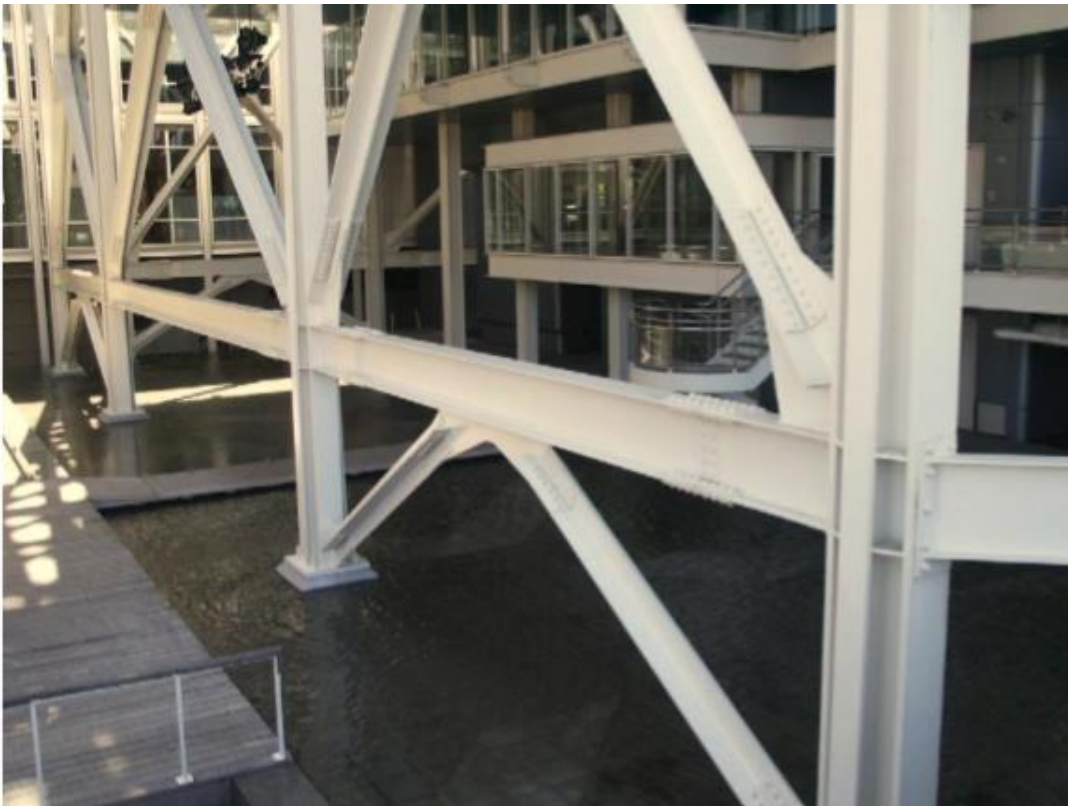
Ilustración 104. Fotografías de arriostramientos y uniones apernadas en placas base, vigas y columnas. Fuente: Serrano, M. M. Cap. XI. Obtenido del informe ARRIOSTRAMIENTO 2015
