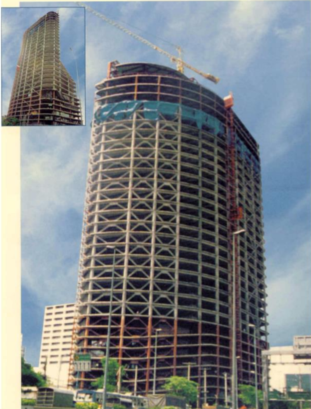
Ilustración 103. Arriostramiento en el edificio ATM Towers. Fuente: Serrano, M. M. Cap. XI. Obtenido del informe ARRIOSTRAMIENTO 2015
