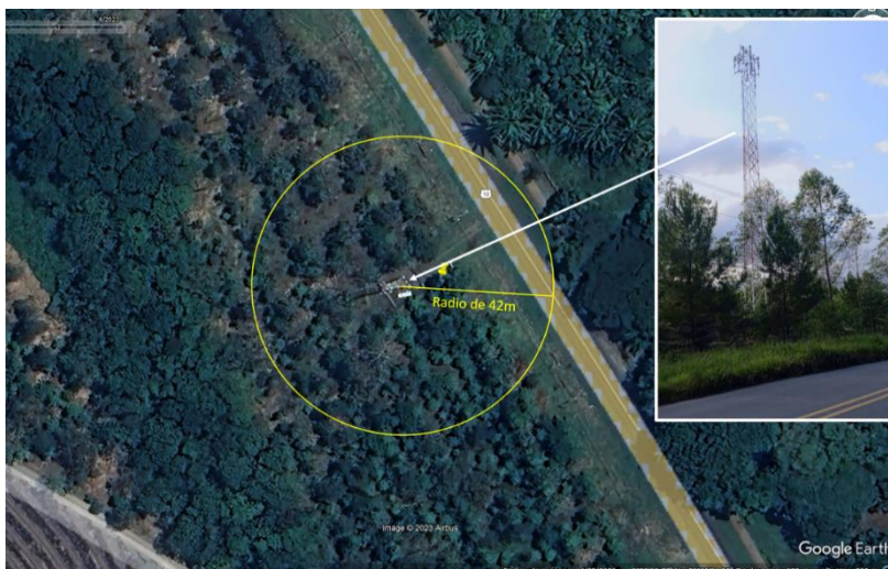
Imagen 29. En la imagen se observa a la cobertura vegetal alrededor de la torre, si bien la misma cuenta con una maya perimetral, si se observan arboles muy cerca de la misma que en el caso de una caída podría ocasionar daños en la estructura. Fuente Google Earth.
