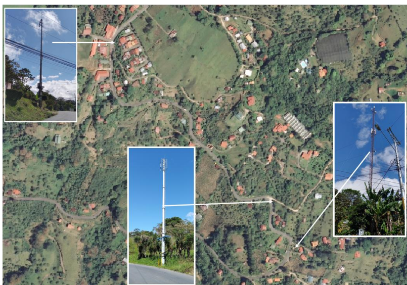
Imagen 21. Distribución de las torres de telecomunicación sobre la ruta N° 230, en una ruta de acceso asfaltadas, de fácil acceso, en el caso de presentarse una eventualidad. Fuente Ortofoto 2017, SNIT.
