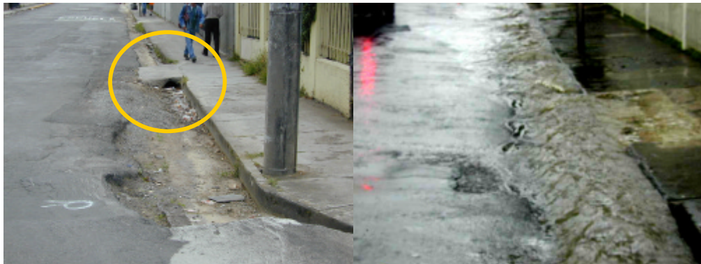
Fotografía 3. Condición de la acera en época seca. En el círculo amarillo se puede apreciar una salida de garaje.
