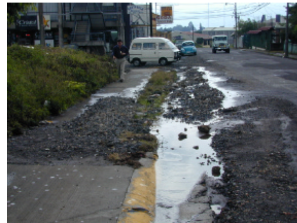
Foto 12. Acera con problemas de inundación.
