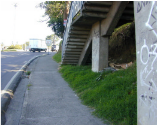
Fotografía 7. Sitio que provoca una sensación de inseguridad para el usuario. Cerca de la Rotonda La Bandera, Mercedes, Montes de Oca.
