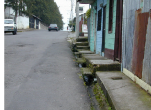
Foto 8. Acera con una superficie en mal estado.
