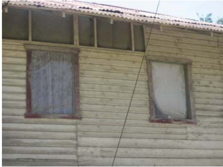
Fotografía 3. Uso de rejillas y aleros, segunda planta del inmueble.
