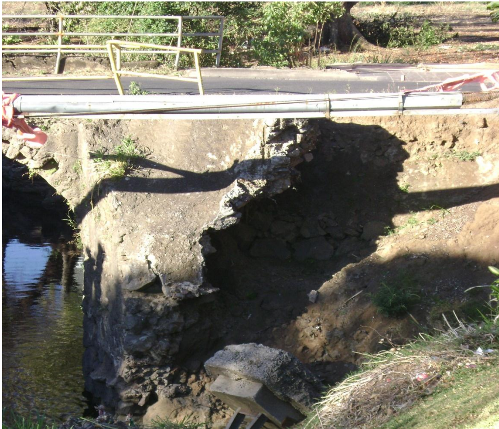
Fotografía 9: Puente del río Burio , donde se observa socavamiento del mismo por el agua. Lo que provoca pequeños deslizamientos de caída de rocas.
