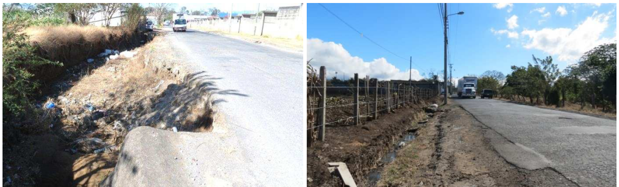
Fotografía 8.2.6 Ejemplos de ausencia de infraestructura de aguas pluviales y falta de aceras en la zona industrial. Fuente: ProDUS-UCR (Febrero 2013)
