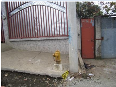
Fotografía 9.2.14 Hidrante instalado en Urbanización Año 2000. Fuente: Trabajo de campo, ProDUS, 2012
