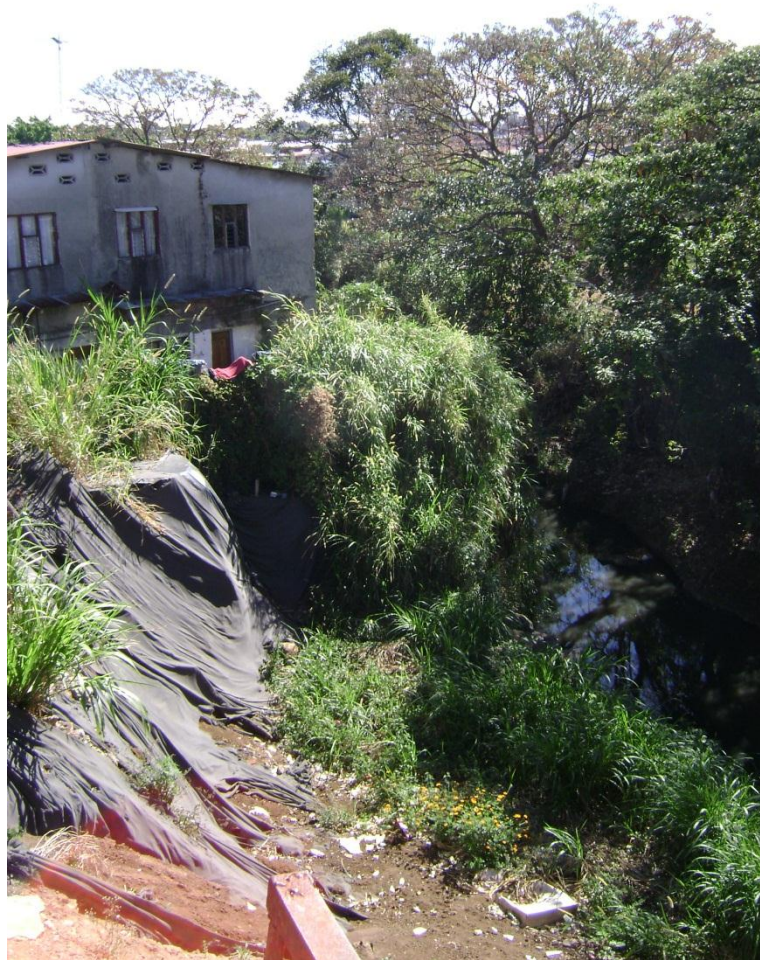
Fotografía 8: Deslizamiento ocurrido, debido a construcciones realizadas dentro del cauce del río. En las épocas lluviosas el cauce asciende y se ensancha, lavando las bases de las construcciones que se encuentran en su cauce.
