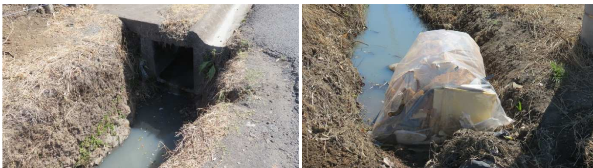
Fotografía 8.2.10 Ejemplos de contaminación de las aguas pluviales de la Z.I. Fuente: ProDUS-UCR (Febrero 2013)
