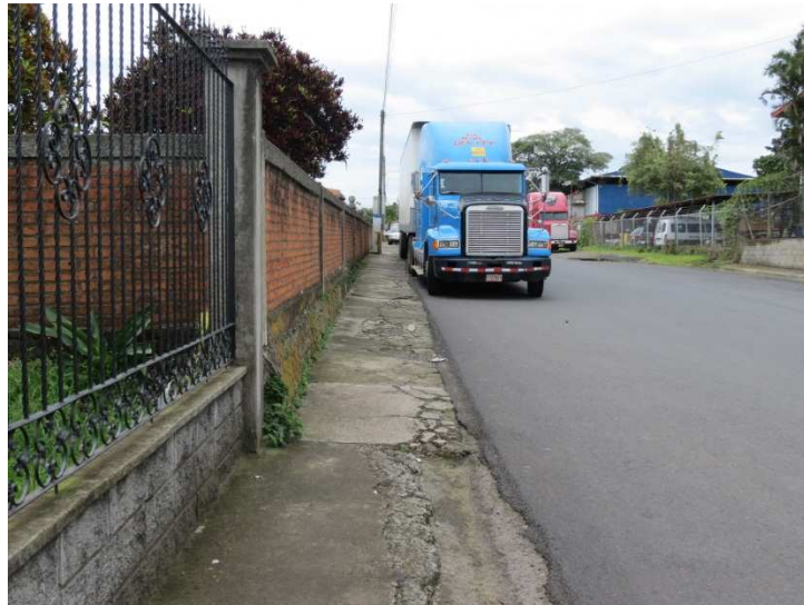
Fotografía 8.2.3 Deterioro en las aceras y cordón de caño por invasión de vehículos pesados Fuente: ProDUS-UCR (Julio 2012).
