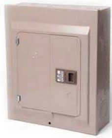
Caja de breaker
