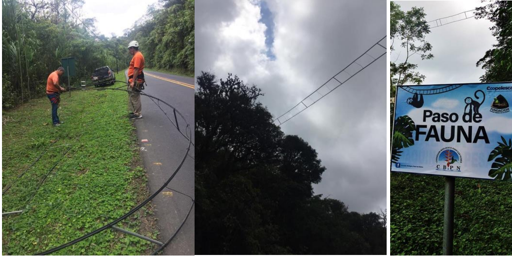
Figura 23. Instalación de los pasos aéreos de fauna por parte del Corredor Biológico Paso de Las Nubes. Fuente: Redes sociales del Corredor Biológico Paso de Las Nubes (2019).
