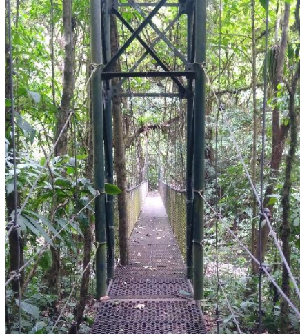
Figura 28. Árbol encima de puente colgante. Fuente: Arrieta (2019).
