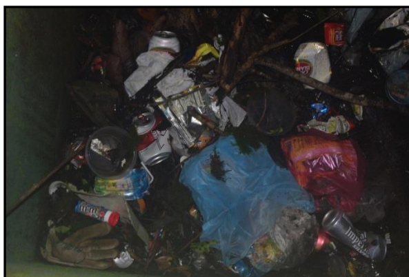
Figura 52. Tanque de transporte y almacenamiento hídrico en estado de abandono y con residuos urbanos perteneciente a la ASADA de Cañas.
