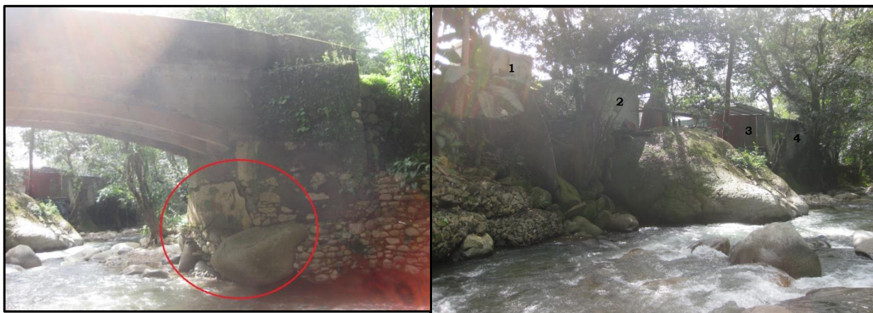
Figura 71: Estructura del puente de Tabarcia con socavamiento y fractura en su parte inferior.
