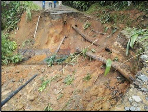
Figura 61. Ruptura de acueductos y desaparición del camino durante el deslizamiento en octubre del 2017 en la comunidad de Cañas en Tabarcia de Mora.
