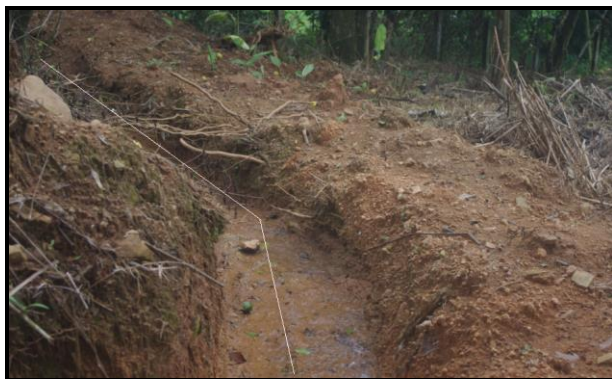
Figura 48. Cárcava formada por desvío de aguas intencional con agua pluvial y residual dentro de una finca particular. Su formación conformación fue ajustada por los afectados a fin de darle dirección hacia una quebrada.
