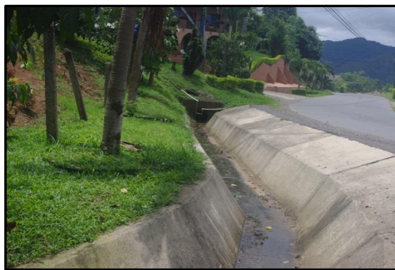
Figura 49. Drenaje de aguas mixtas (pluviales y servidas) a cielo abierto en Tabarcia de Mora con depositación directa hacia el río Tabarcia.
