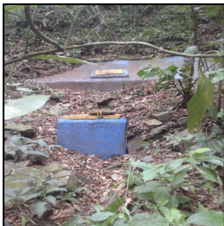
Figura 34 Naciente de la ASADA de Tabarcia con captación de cemento y candado (parte superior); la parte inferior corresponde a una fuente de almacenamiento.
