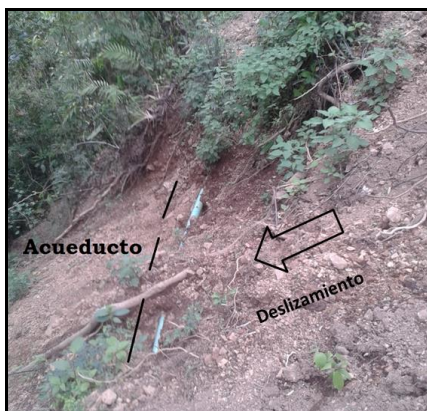
Figura 38. Deslizamiento activo (El Indio Pelao) sobre una parte del acueducto de la ASADA de Tabarcia de Mora.
