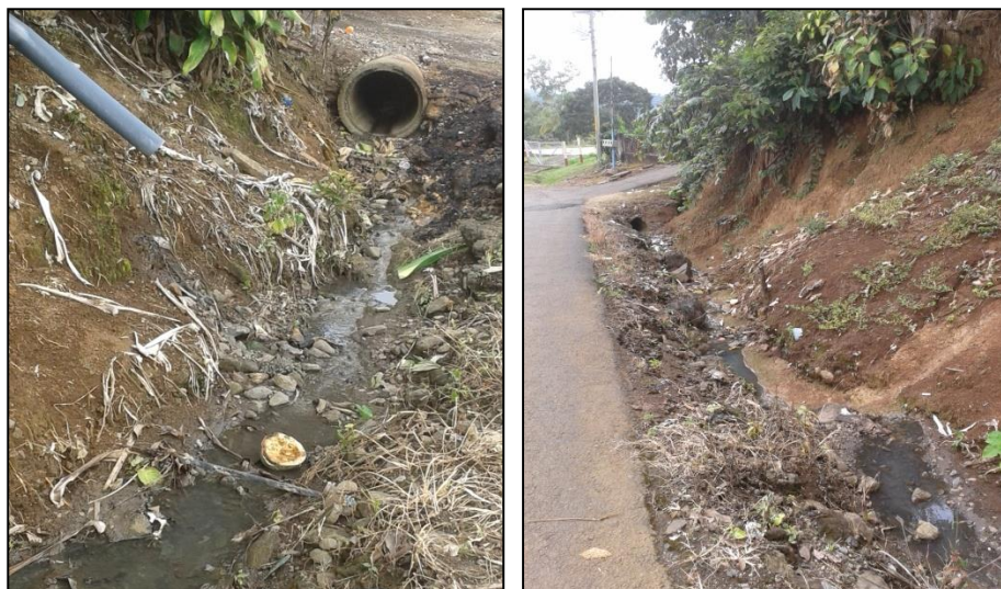
Figura 15. Desecho inadecuado de aguas residuales
