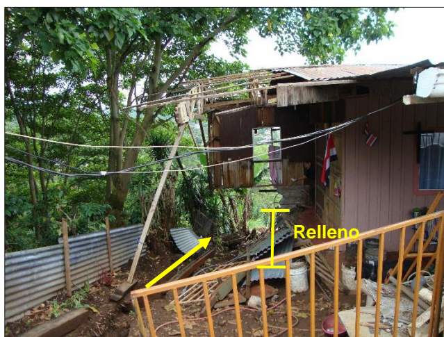
Figura 10. Vivienda afectada por asentamientos en relleno
