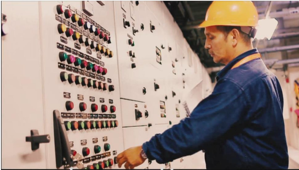
Figura 5. Operación local de plantas hidroeléctricas
