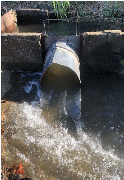
A 28. Funcionamiento de Compuerta.
