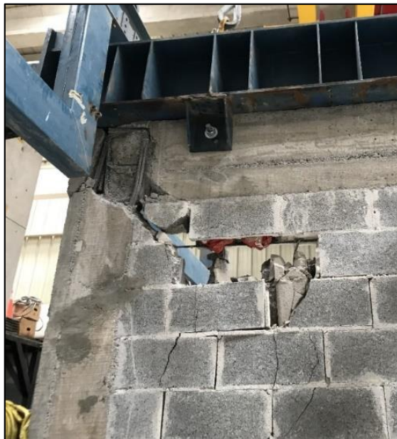
Figura 54. Estado final del nudo Muro RA.75.
