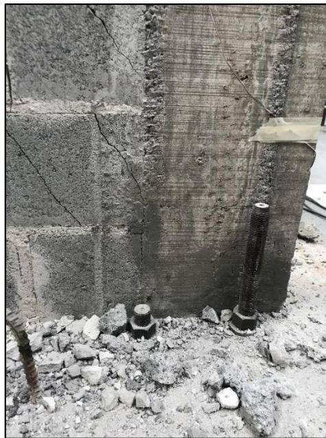
Figura 58. Grietas en la base del muro RA1
