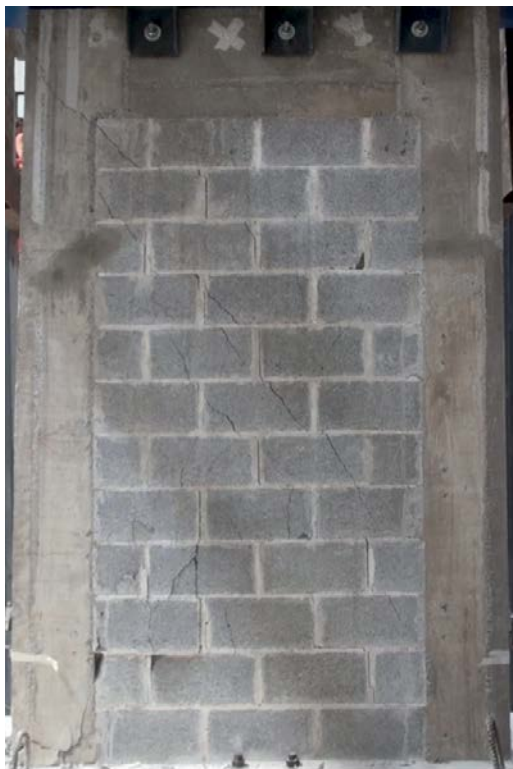
Figura 68. Agrietamiento parcial del Muro D para el 1° ciclo de la 10° serie ( \pm 85 mm).
