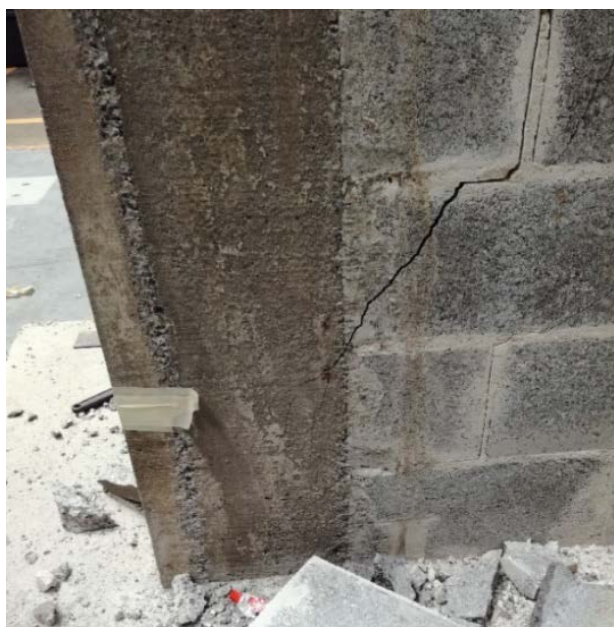
Figura 57. Agrietamiento final en la base del Muro B.
