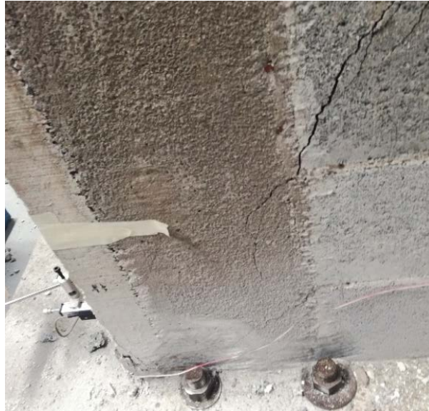
Figura 64. Aplastamiento final en la base de la columna del Muro C.
