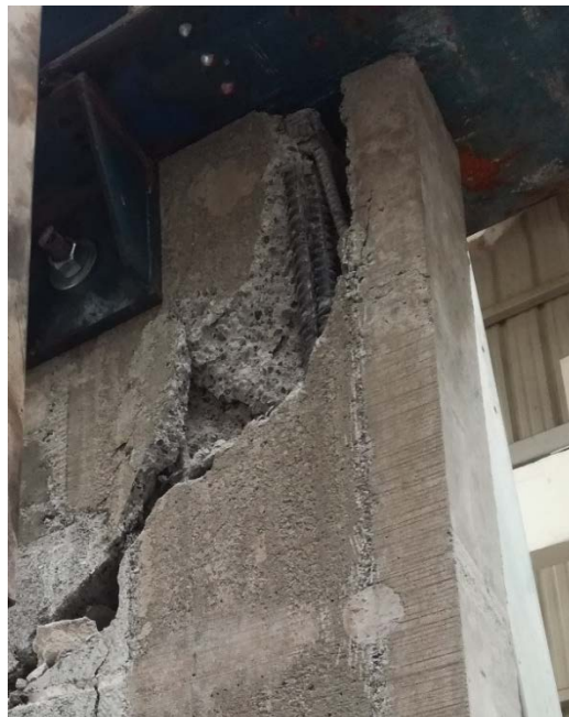
Figura 63. Condición final del nudo del Muro C.
