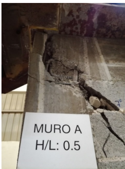
Figura 52. Condición final del nudo superior izquierdo del Muro A.
