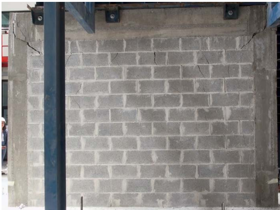
Figura 56. Agrietamiento parcial del Muro B para el 3° ciclo de la 8° serie ( \pm 48 mm).
