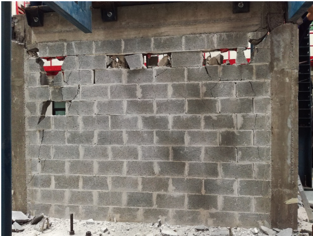
Figura 59. Condición final del Muro B.
