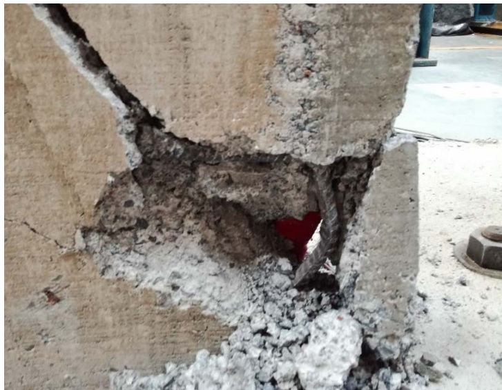
Figura 69. Pandeo del acero en la base de la columna del Muro D.
