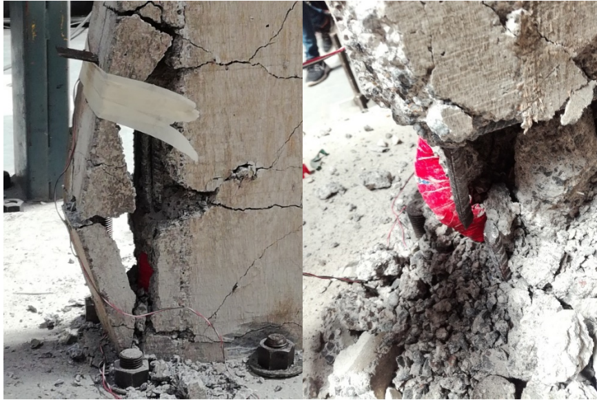
Figura 74. Aplastamiento del concreto y ruptura del acero de refuerzo de la columna del Muro E. La condición final del muro se presenta en la Figura 75.
