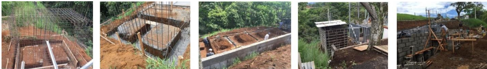
Ilustración 67: Construcción de cimientos y muro de retención. Fuente: AE Diseño y Arquitectura, 2019.
