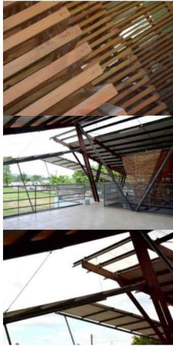
Ilustración 38: Vistas de algunos detalles constructivos. Fuente: Centro de Cuido y Desarrollo Infantil de Nicoya, Entre Nos Atelier, 2013, ( http://arquitecturaenacero.org )
