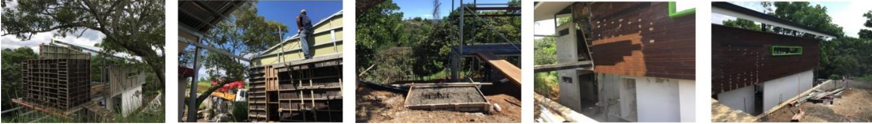
Ilustración 68: Construcción de paredes de primer y segundo nivel. Fuente: AE Diseño y Arquitectura, 2019.
