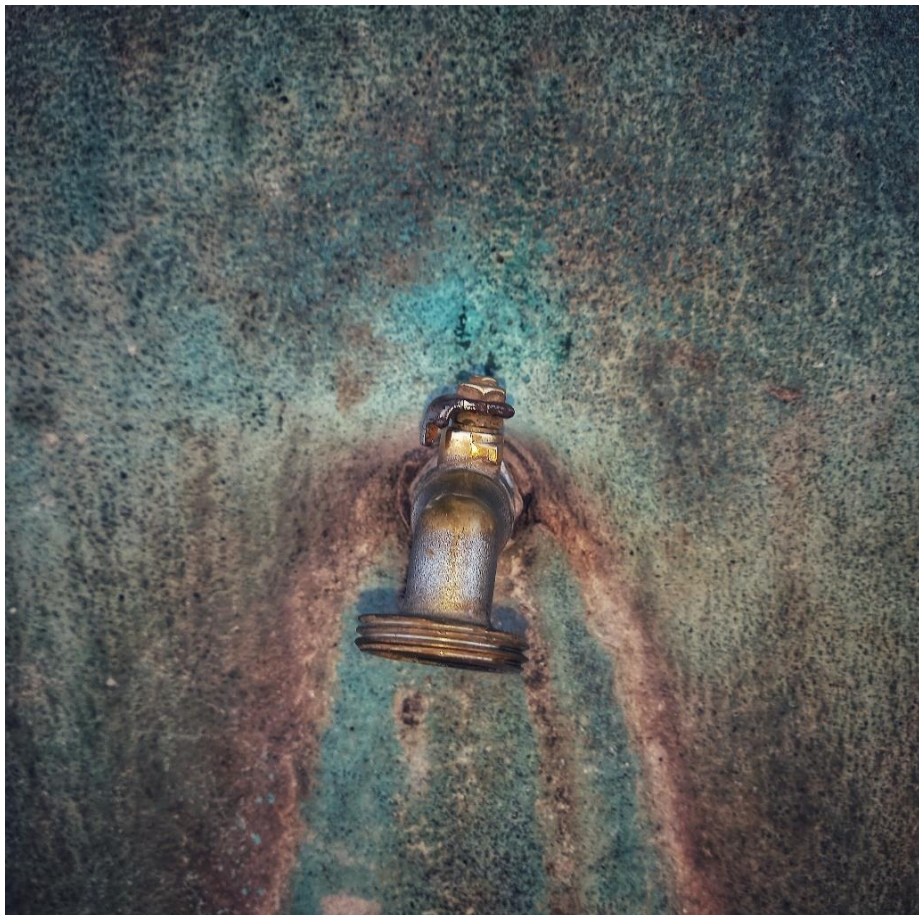
FIGURA 3: VANDALISMO A CANILLAS
