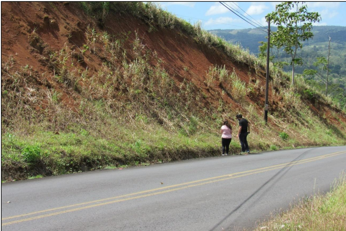
Fig. 31. Afloramiento sumamente meteorizado de la Formación Monteverde ubicado en un corte de la carretera que comunica Jicarito con Venado (coordenadas 419734/1168215) donde ser observan bloques lávicos contenidos en una matriz arcillo-arenosa.
